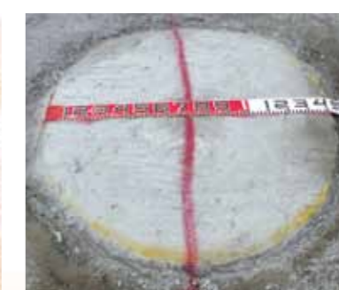
改良体杭頭部径確認(φ 1400) オールコアボーリングのコア状況 (フェノールフタレイン噴霧)
